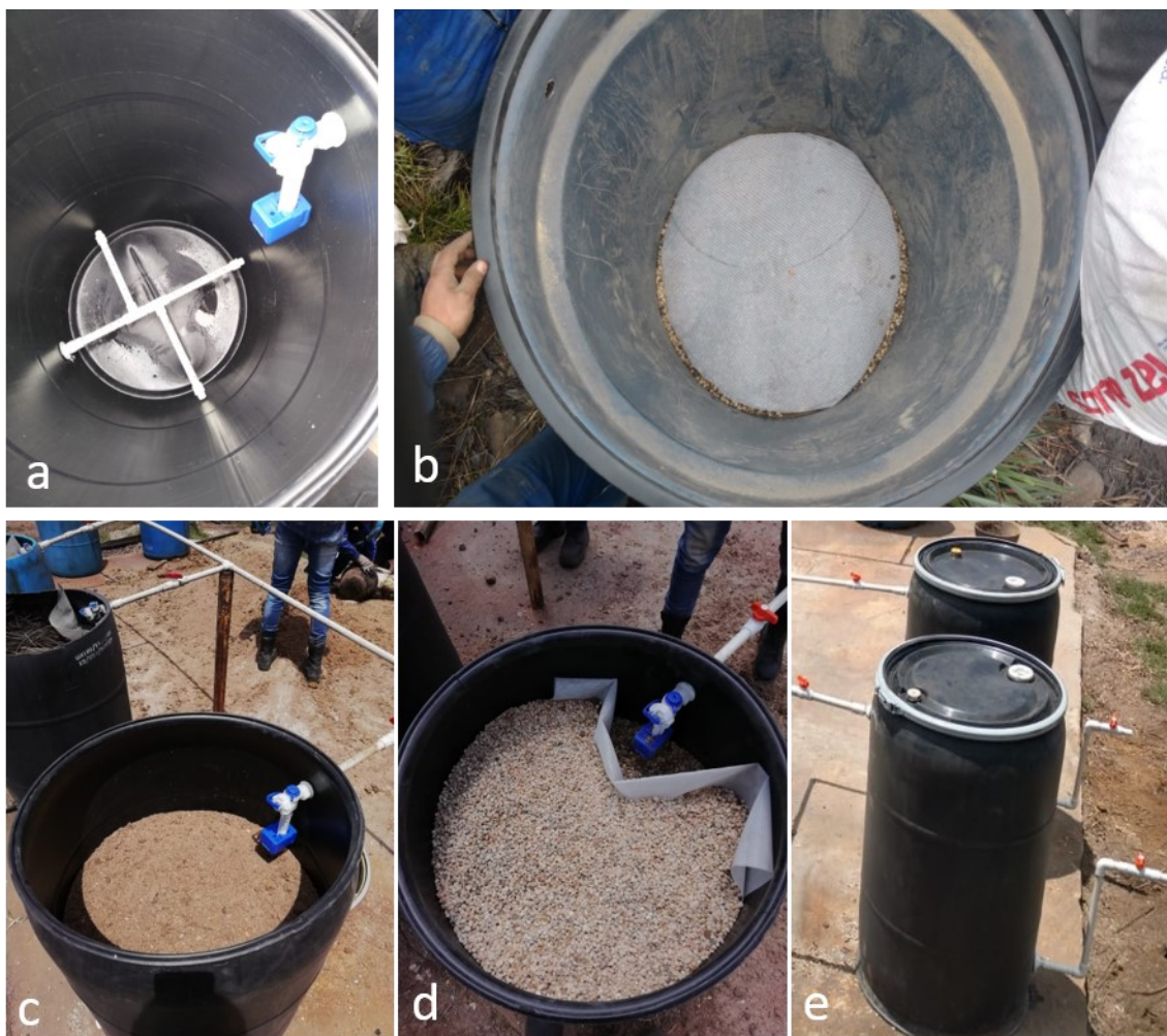
Figura 3. Montaje y puesta en marcha de un RBP piloto con flujo descendente: a. Tubería de descarga del DAM tratado, b. capa de gravilla y geomembrana, c. mezcla reactiva, d. capa de gravilla de la parte superior, e. reactor completo. (Fotografías Vásquez Y).
