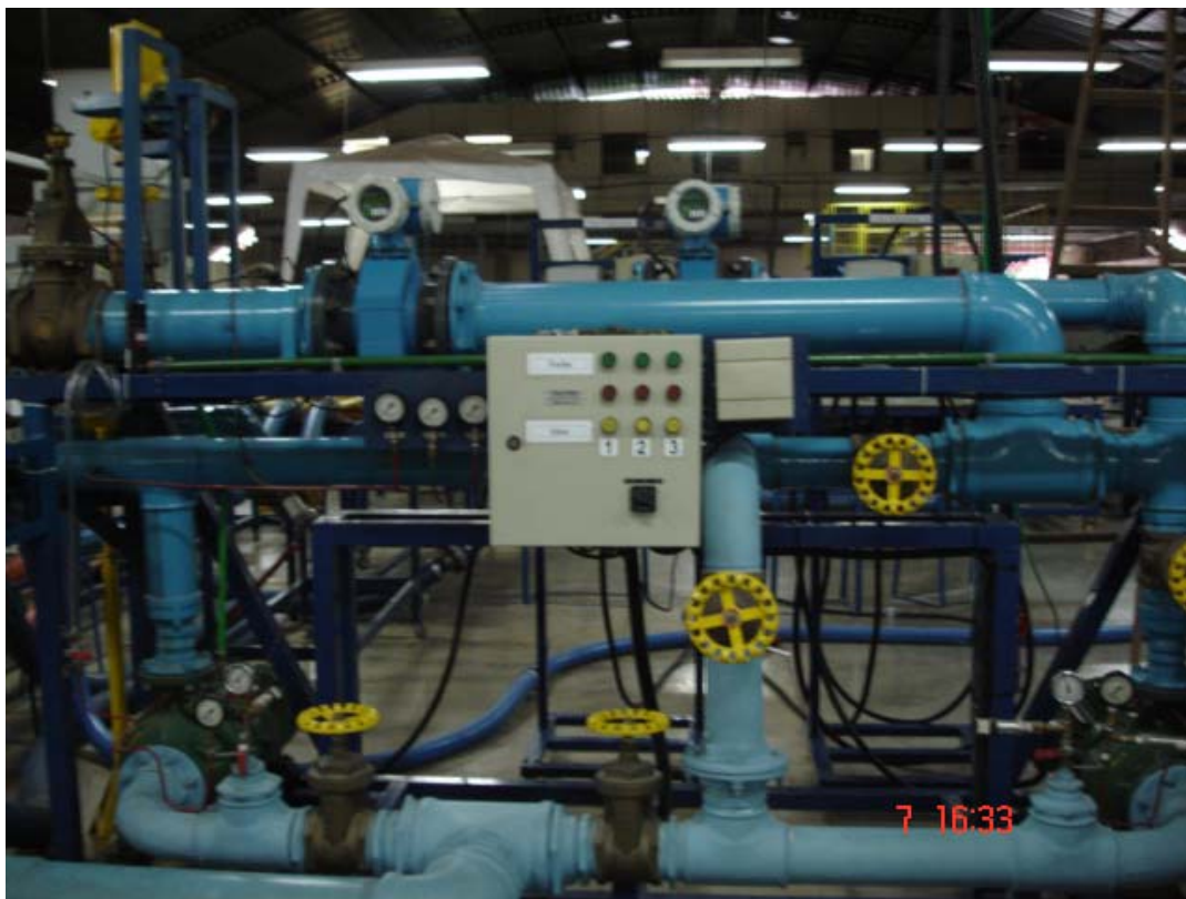
Figura 4 – Bancada de bombeamento equipada com um sistema de controle de vazão e medidores de vazão
