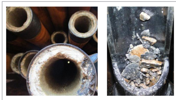
Figura 7. Evidencia de incrustaciones de carbonato de calcio en aparejo de producción recuperado y herramienta pateadora de 3 5/8”.
