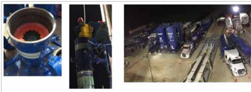
Figura 3. Equipo para la corrida de la tubería y accesorios utilizados para la cementación de la tubería de revestimiento de 20"³.
