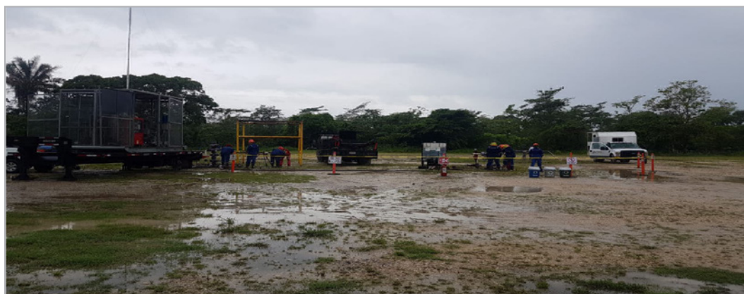
Figura 14. Conexiones superficiales para la inyección de gas caliente utilizando el MTC operando en el pozo Los Soldados 482.
