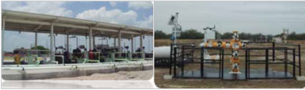
Figura 8. Fotografías de una planta y de un pozo inyector.
