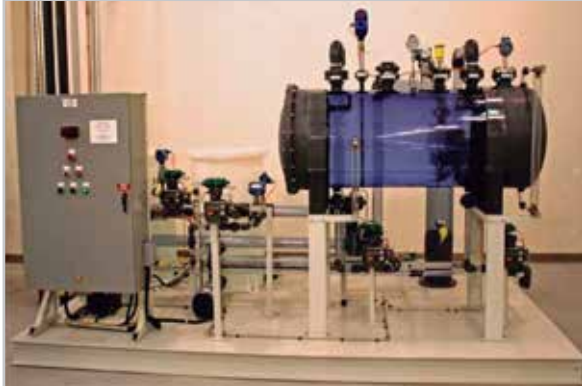
Separador de dos y tres fases
