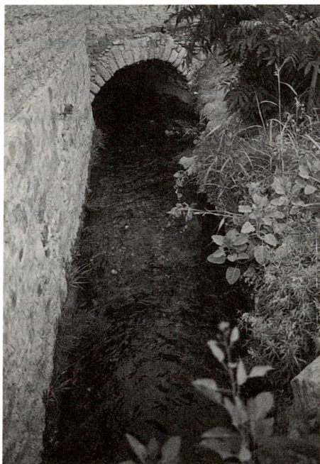
Fig. 5. Valle de Allende. La acequia del pueblo, hoy de cal y canto y en parte subterránea. Data probablemente de fines del siglo XIX. Foto: Chantal Cramaussel.
