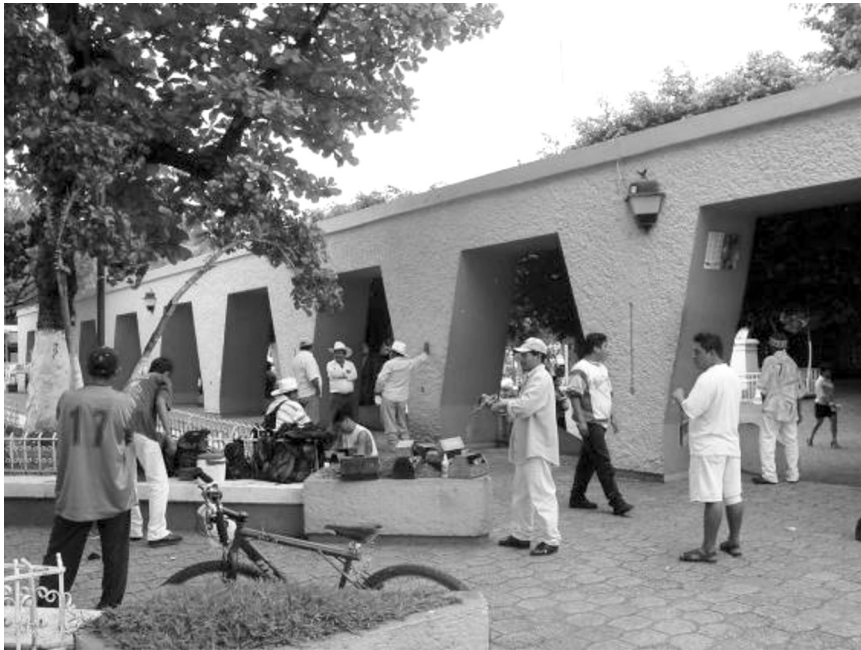
Fig. 12. Vista de los arcos que fragmentaban el espacio del Parque Central y que fueron demolidos para la rehabilitación.
