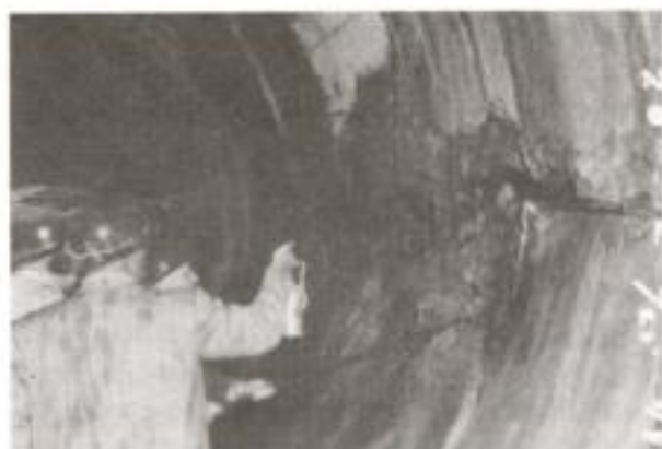
La fotografía muestra el detalle del deterioro en el interior del Túnel Viejo a la altura del km 4, y el momento en que los ingenieros del Consultivo Técnico realizan una inspección. (ATA), Consultivo Técnico, c. 190, exp. 1,548, f. 78, foto número 284-2.
