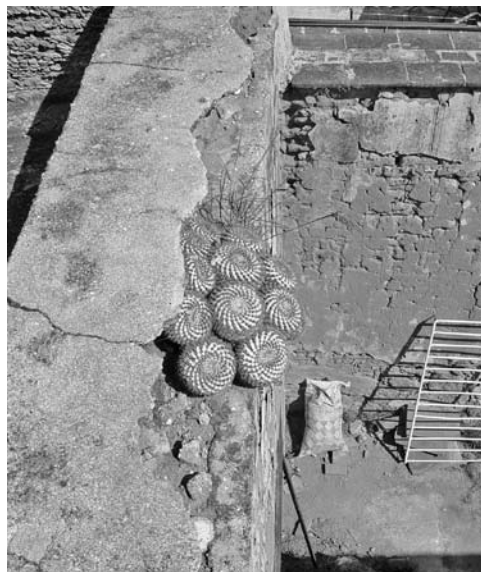
Figura 3: Problemas de vegetación parásita en las ruinas de adobe de una hacienda colonial. Aguascalientes, México.
