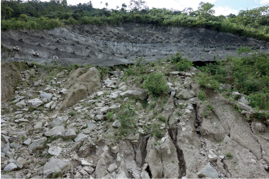
Figura 10. Movimiento de remoción de rocas en parte inferior del muro
