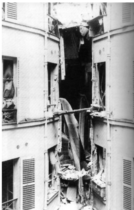
Figura 4. Estragos causados por la bomba puesta por Ravachol en la casa del procurador de la República M. Bulot. 1892.
