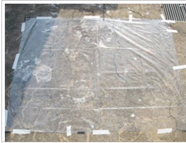
Figura 8. Mapeo de las grietas en la losa Figure 8. Mapping of cracks along the slab
