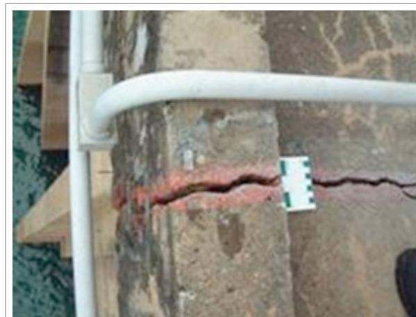
Figura 13. Agrietamiento de la losa, con refuerzo expuesto; mostrando el muro de contención al fondo Figure 13. Cracking in the slab with exposed reinforcement, with buttress in the background
