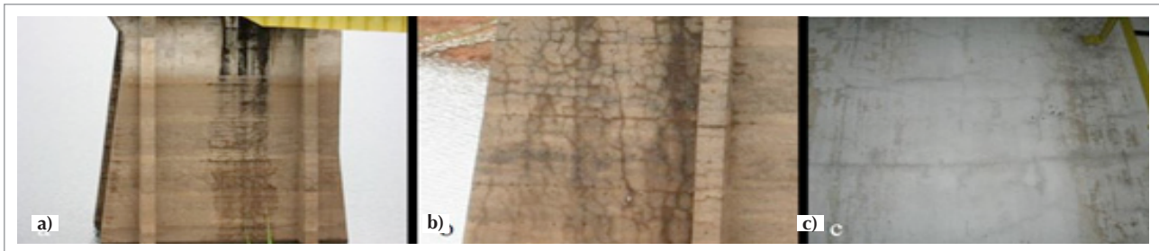
Figura 5. Grietas aleatorias en las fachadas interiores y exteriores de los muros y muros de contención, en la entrada de agua. (a) Muro exterior, (b) muro de contención y (c) muro interior
