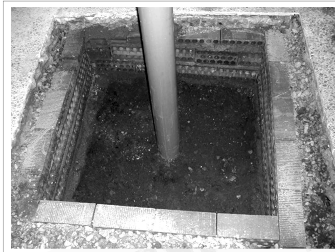
Figura 13. Fotografía de la construcción de la arqueta situada bajo la solera de sótano Figure 13. Picture of construction of SUMP inserted under basement slab
