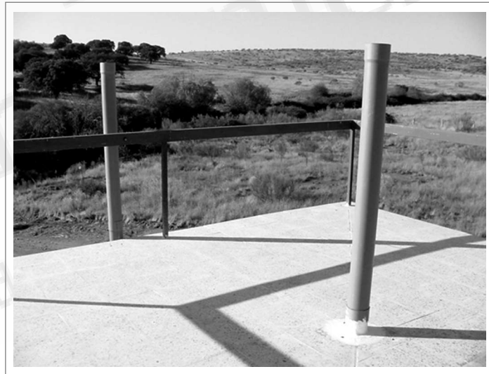
Figura 14. Salida de los tubos a cubierta. En esta fotografía se encuentran sellados en su extremo Figure 14. Tubes output to the roof. This picture shows tubes sealed in the base
