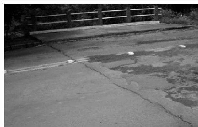
Figura 4. Deterioro del pavimento Figure 4. Deck deterioration
