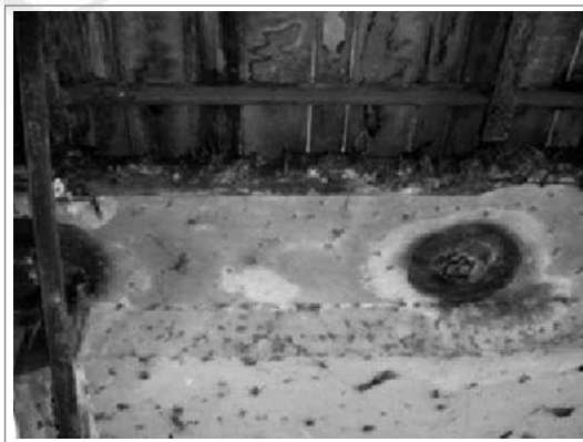
Figura 6. Estado de desintegración de la acera
