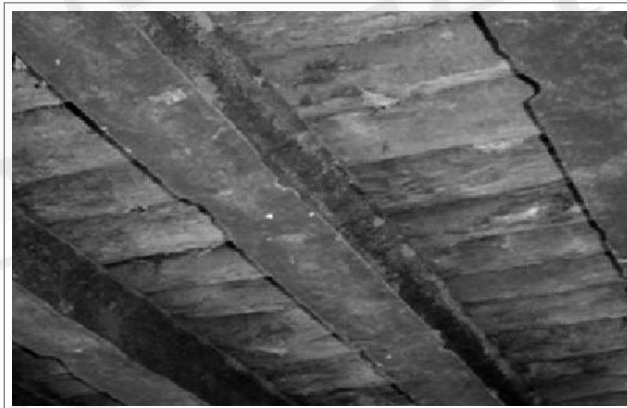
Figura 3. Corrosión del acero Figure 3. Steel corrosion
