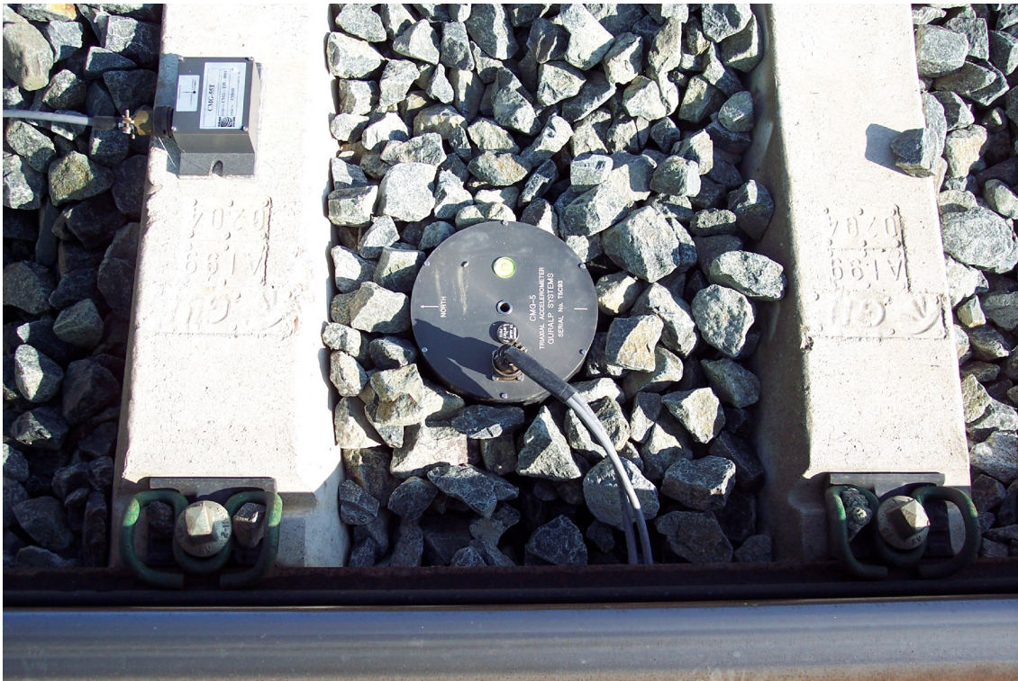
Figura 5. Emplazamiento de los acelerómetros instalados en la traviesa y en el balasto durante la primera campaña de toma de datos, en enero de 2008
