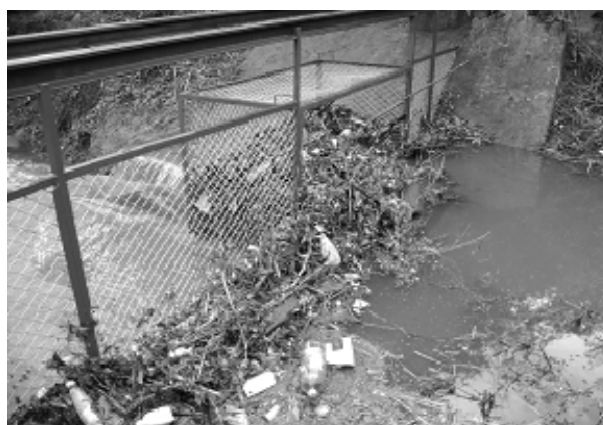
Figura 5 - Resíduos sólidos retidos na estrutura
