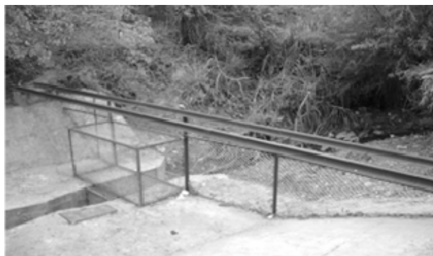
Figura 4 - Foto da estrutura de coleta instalada.
