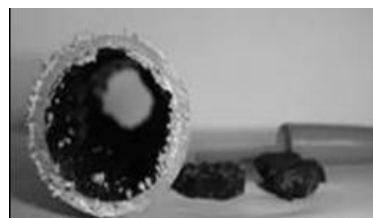
Figura 1 – Precipitado obstruindo a tubulação.
