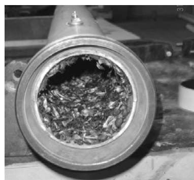
Figura 7 - vista frontal da tubulação com uma infestação de 0,5 ind./cm 2 .
