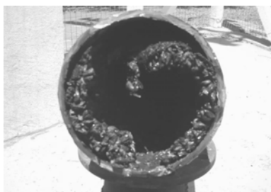
Figura 4 – Vista frontal de adutora de ferro fundido sob efeito de macrofouling . Fonte: CORSAN – Barra do Ribeiro/RS em 2007.
