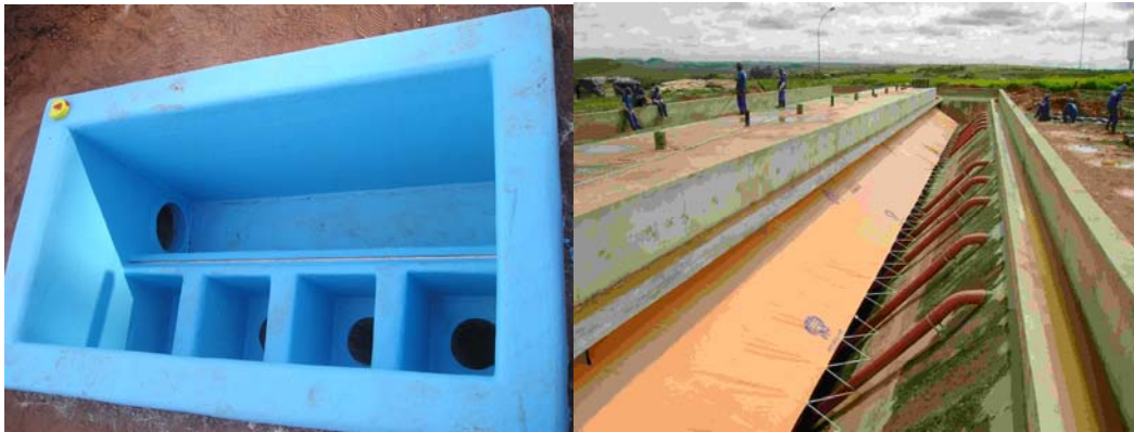
Figuras 7 e 8 – Implantação de alterações de projeto nos reatores UASB das ETEs Paranoá (revestimento das caixas de coleta do efluente tratado com fibra de vidro) e São Sebastião (substituição do material dos separadores de fases por laminado vinílico).
