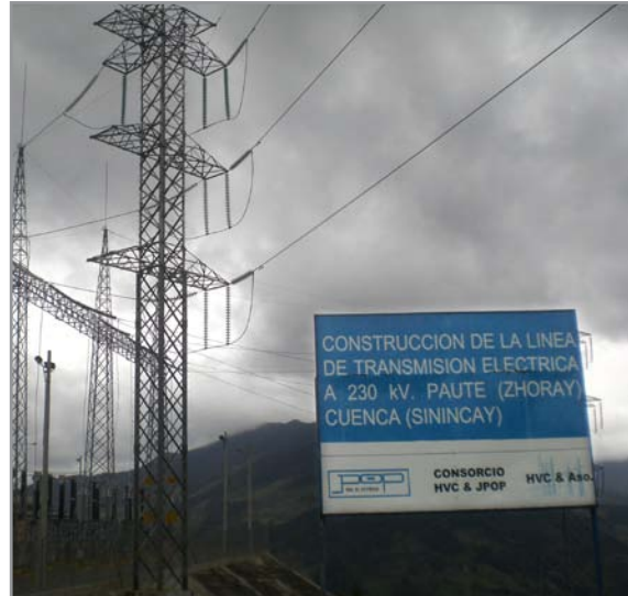
Subestación y línea de transmisión eléctrica de la Central Mazar.
