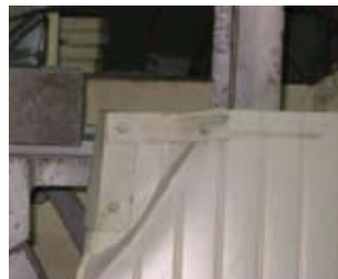
Figura 14c. Estado del panel luego del ensayo experimental
