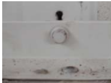
Figura 10b. Falla por desgarramiento del sistema
