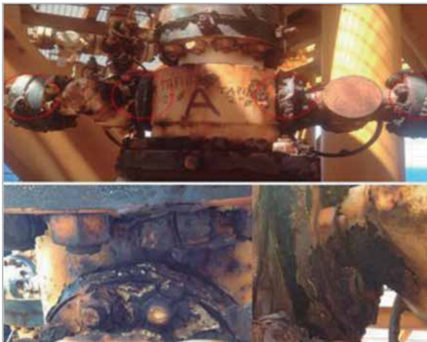
Figura 5. Condiciones de cabezal de tuberías, sección B.
