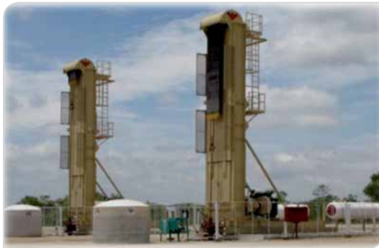
Figura 12. Bombas mecánicas tipo Rotaflex utilizadas durante la prueba piloto.
