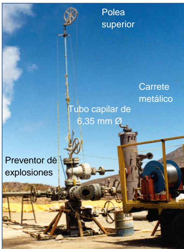
Fig. 3. Equipo superficial del sistema de neutralización
