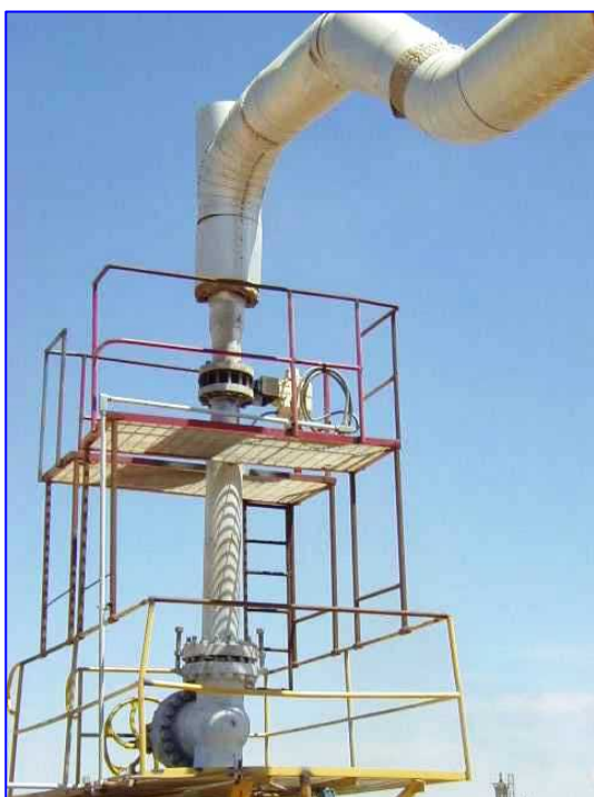
Foto 1. Instalaciones para el control en el cabezal del Pozo 227.
