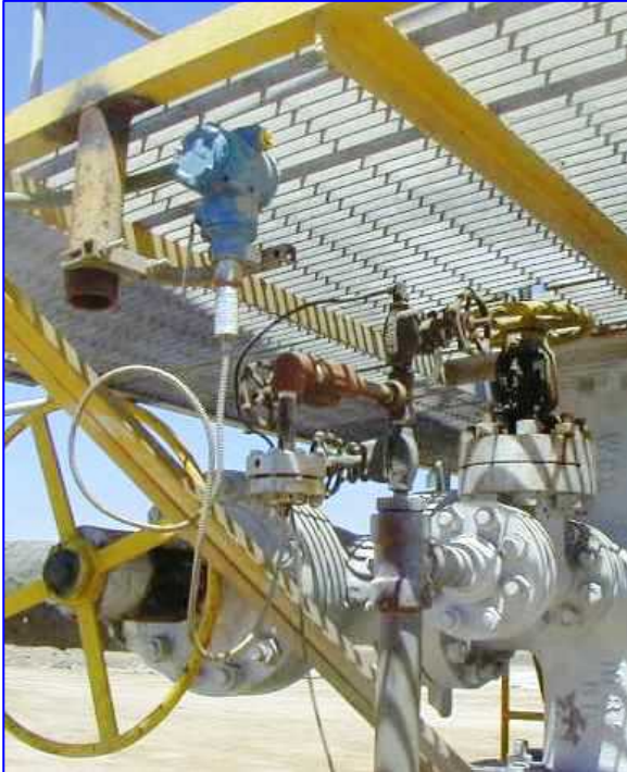
Foto 2. Transmisor de presión en cabezal del Pozo 227
