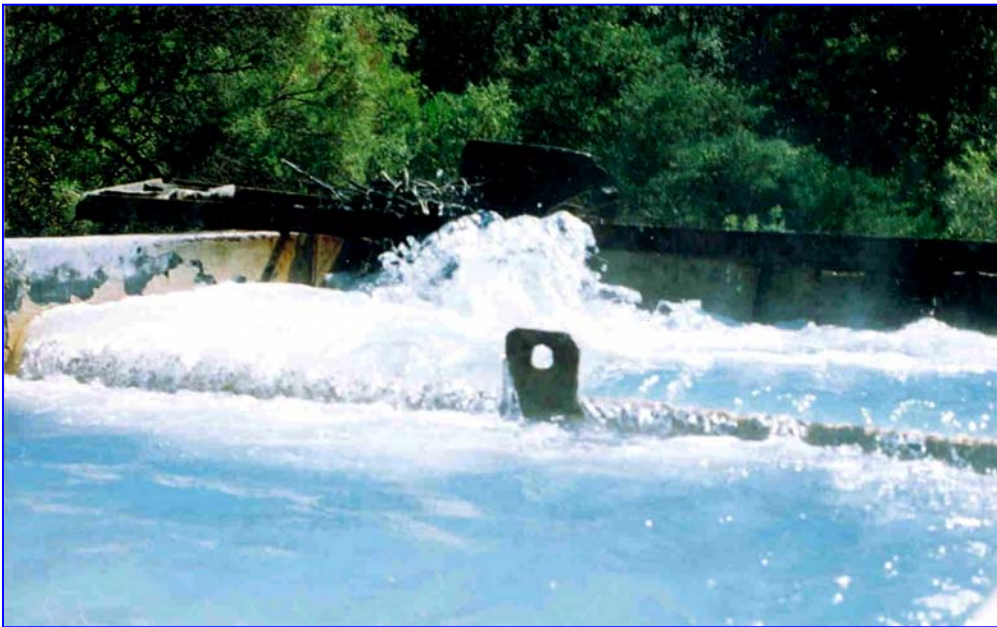
Fig. 6. Caja rompedora de presión con dispositivo que relaciona el tirante de agua con el flujo
