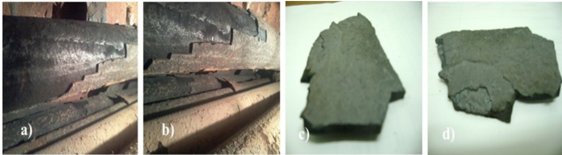
Figura 1. Películas adheridas a la superficie de los tubos en la zona de convección del horno
