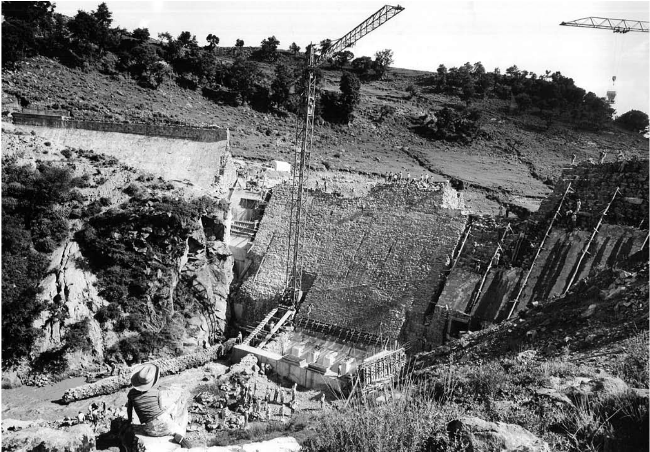
Construcción de la presa Tepetitlán, 1964, San Felipe del Progreso, Estado de México. AHA, Colección Fotográfica, caja 637, expediente 17978.
