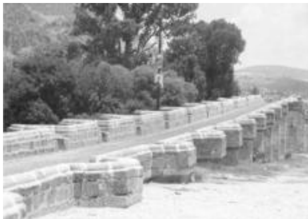
Vista superior del puente de Acámbaro, Guanajuato, mostrando el perfil quebrado de sus pretilos. Fotografía de Guillermo Boils.
