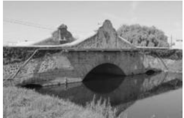
Vista del puente de Lerma, México, desde el sudeste. Fografía de Guillermo Boils.
