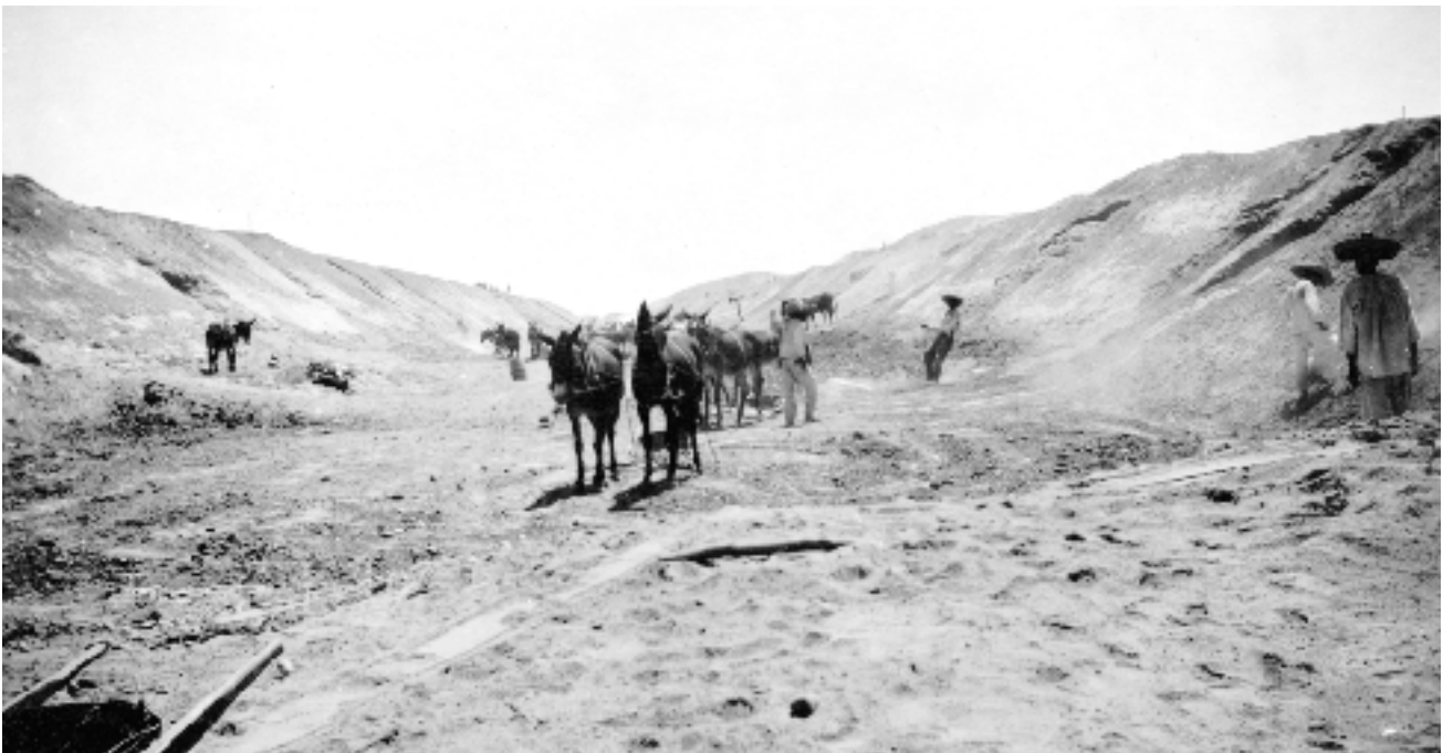
“Trabajos de ampliación del canal Gilita y Anexas”, 1928, Viesca, Coahuila, AHA, Aprovechamientos Superficiales, c. 213, exp. 5112
