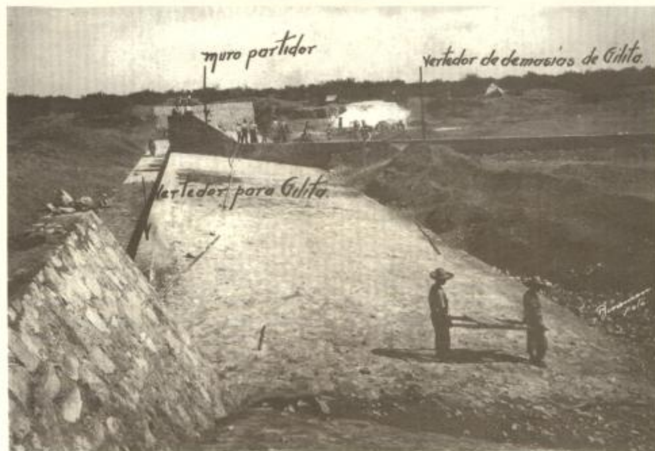
Vista general de la construcción del vertedor y muro partidor para Gilita, Coahuila (1927), AHA, Aprovechamientos Superficiales, caja 1175, exp. 16429, f. 68-69.
