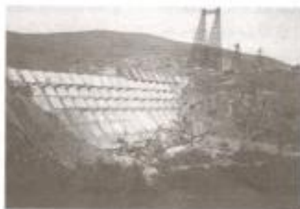
Vista general de las obras de construcción de la cortina de la presa Rodríguez, río Sonora, Sonora (1933). AHA, Consultivo Técnico, caja 68, exp. 14, f. 95.
