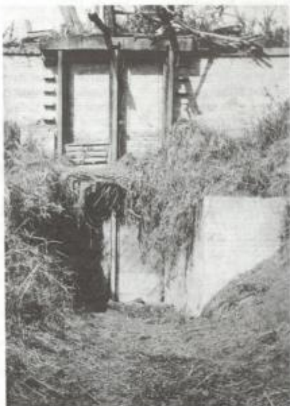
Estado de abandono del túnel de la hacienda El Limón, río Choy, San Luis Potosí. 1923. AHA, caja 144, exp. 3344, f. 56
