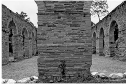
Figura 7: Estado ruinoso de la Ferrería de Amagá en Antioquia (Colombia), construida en 1865, bien de interés cultural de carácter nacional en la categoría patrimonio arquitectónico para la industria.
